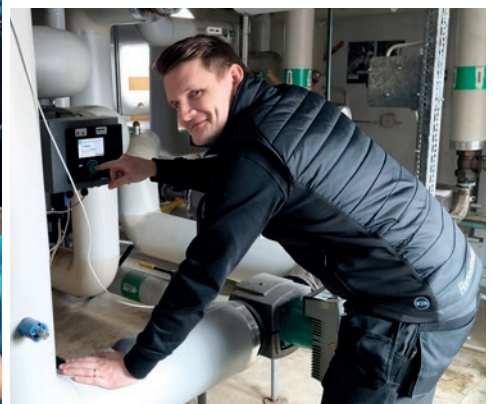
Nya driftteknikern Erik Andersson gör kontroll i en av undercentralerna på Sveavägen, Högaloft i Värnamo.
